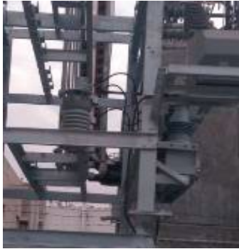
Conexión de apartarrayos a contactor
