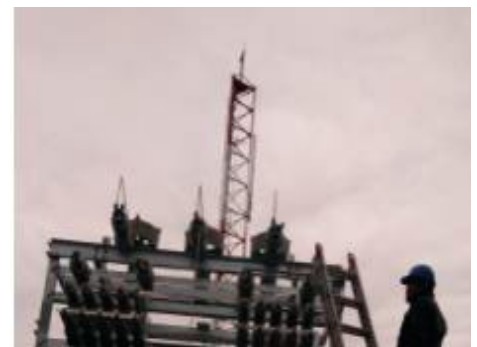
Conexión de reactor aislador que alimenta al BUS de Capacitores
