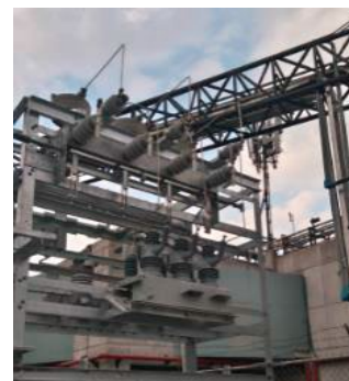
Conexión de reactor a cuchilla de puesta a tierra con redondo de cobre
